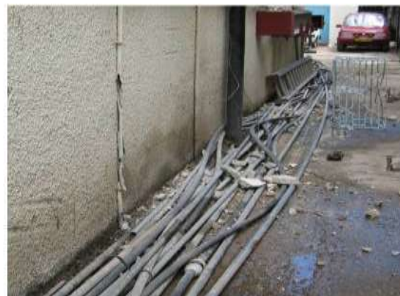
Foto 3.24 Fascio di condotte nel centro di Dar es Salaam (Kjellen, 2006)
