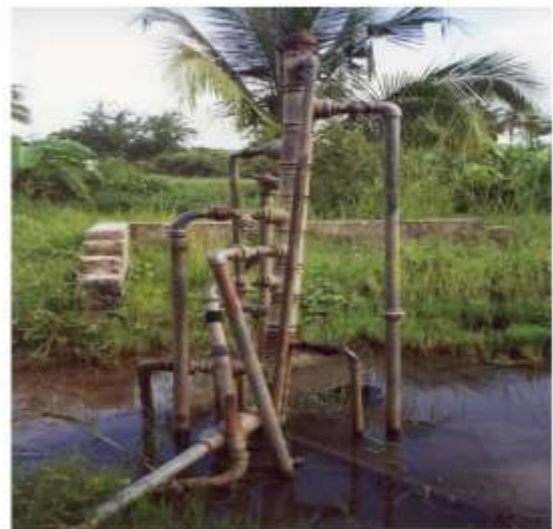
Foto 3.20 Insieme di connessioni secondarie alla condotta di trasmissione sotterranea nell'area di Kimara (Kjellen, 2006)
